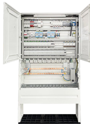
SON - Szafy oświetlenia ulicznego
